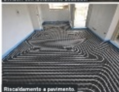
Riscaldamento a pavimento.
